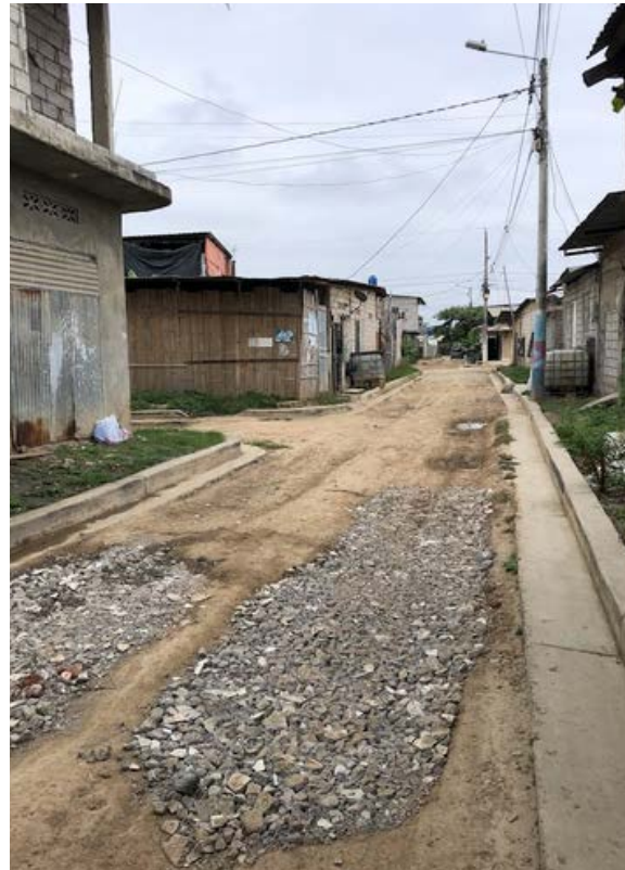
Calle arreglada por parte de los residentes
