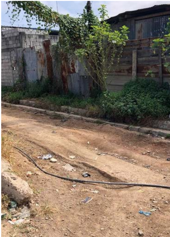
Calle con erosión de lluvia
